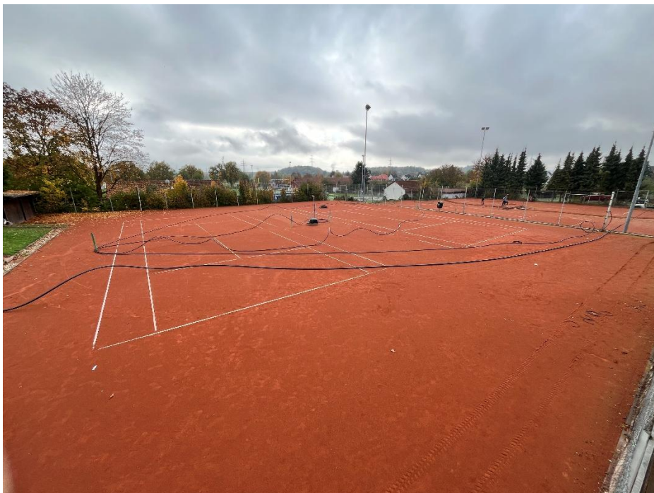
Abbildung 2 wildes Durcheinander der neuen Wasserleitungen
