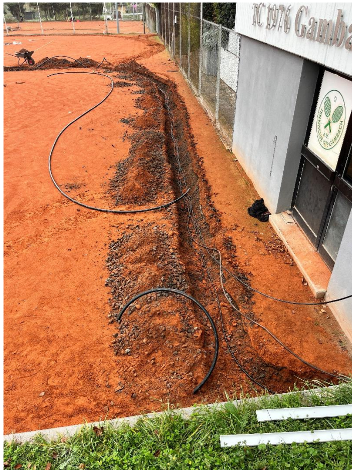
3 Strom- und Wasserleitungen zu den Plätzen 1+2
