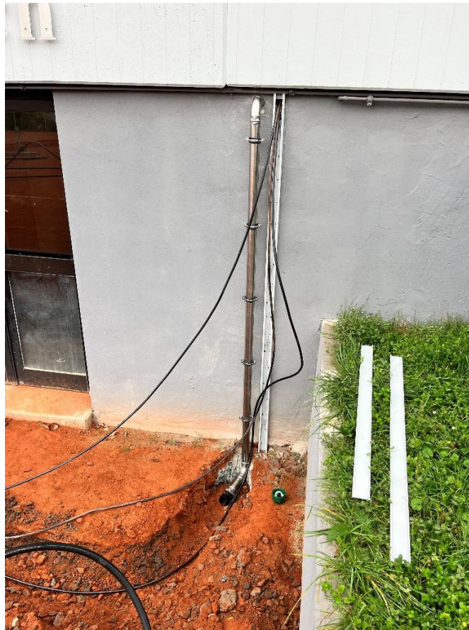
1 Die Hauptwasserleitung zu den Sprinklern
